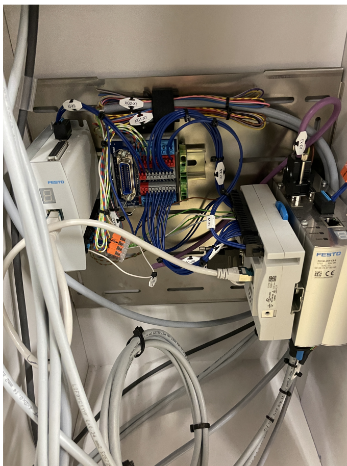
Obrázek 5.1: Původní stav rozvaděče stanice
