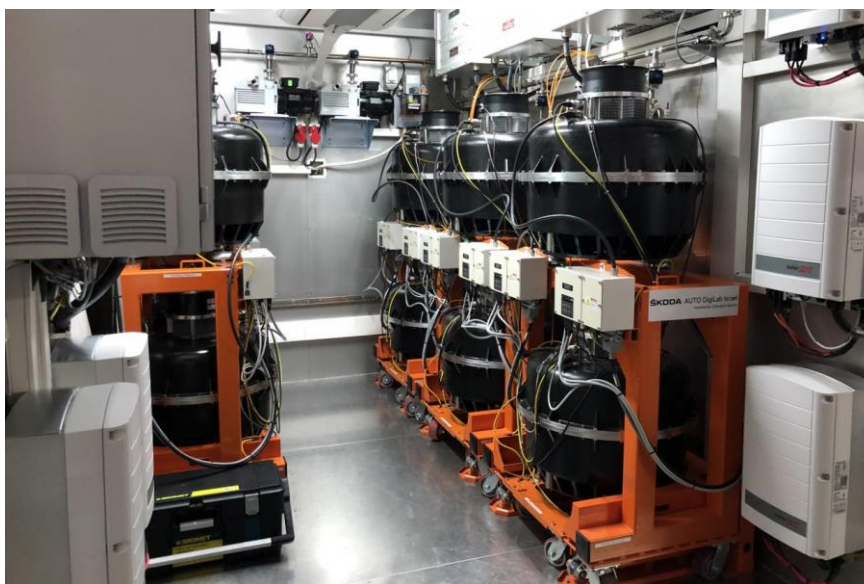
obr. 17 Vnitřek kinetické dobíjecí stanice (Koval 2019)
