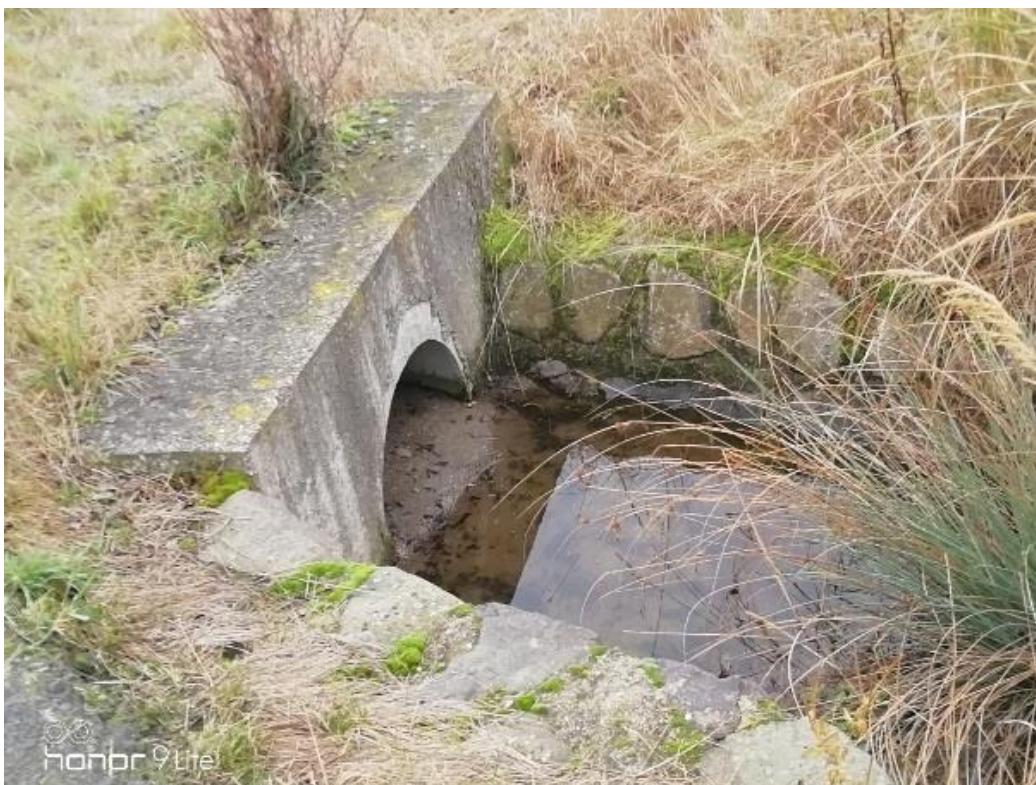
Cesta HC 1 – propustek, voda neodtéká
