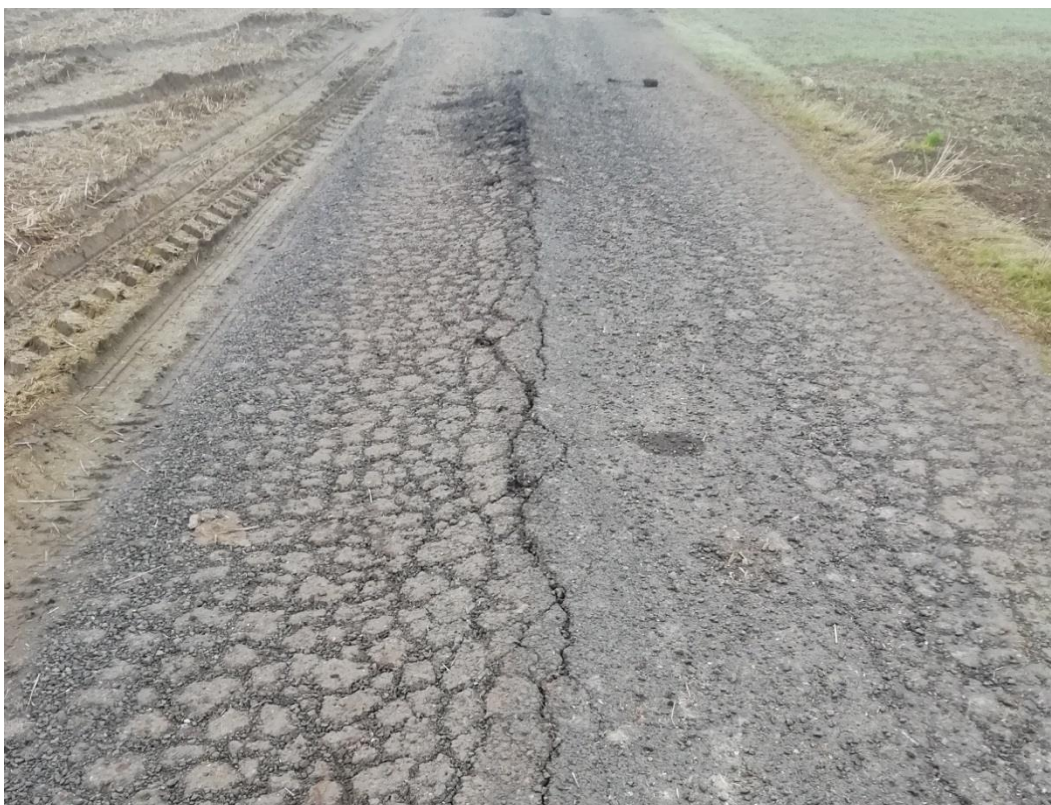
Cesta HC 1 – staničení km 0,000 – 0,800 – podkladní vrstvy, narušení zvlnění do hloubky až 300mm
