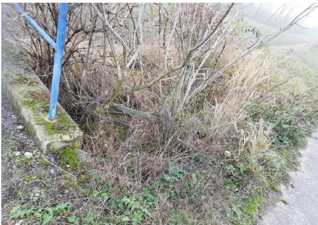
Cesta HC 2 – propustek, příkop zarostlý, nečištěný
