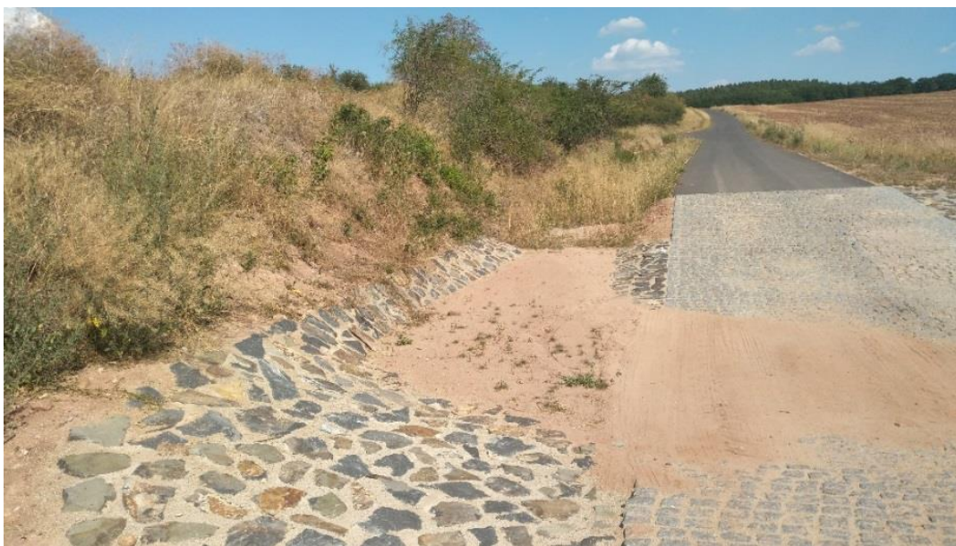
Cesta HC 2 – brod – po dokončení stavby, málo vegetace došlo ke smyvu půdy, byla uplatněna reklamace v rámci záruky stavby (MĚSTO BLŠANY 2018)
