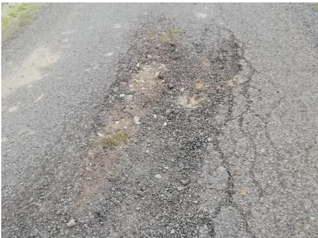
Cesta HC 1 – staničení km 0,000 – 0,800 – výrazné narušení povrchu a pokladních vrstev
