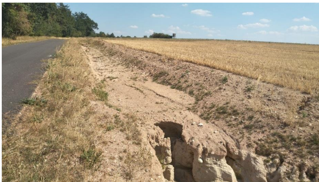
Cesta HC 2 – zasakovací průleh – po dokončení stavby, málo vegetace došlo ke smyvu půdy, byla uplatněna reklamace v rámci záruky stavby (MĚSTO BLŠANY 2018)
