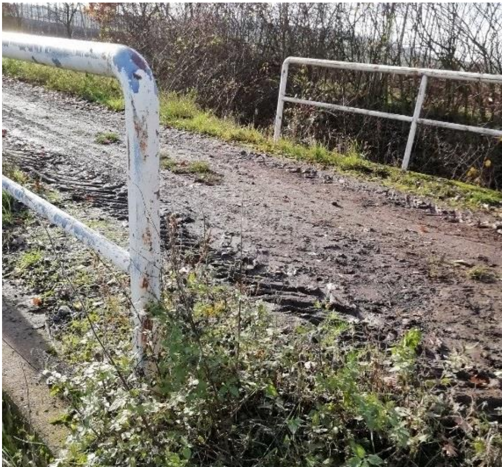
Cesta C 1 – zábradlí na propustku, propustek zanesený, ale funkční
