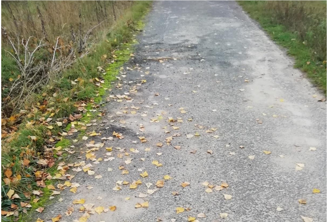
Cesta HC 2 – stav konstrukce vozovky, drobné praskliny na asfalt. povrchu
