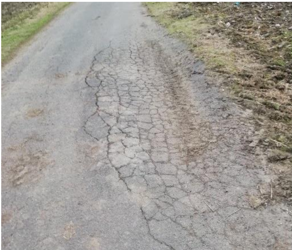
Cesta C 2 – stav konstrukce vozovky, lokální praskliny na asfalt. povrchu
