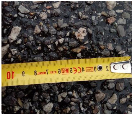
Obr. 46 Povrch zkušební tratě v Kopřivnici [Vlastní zdroj]
