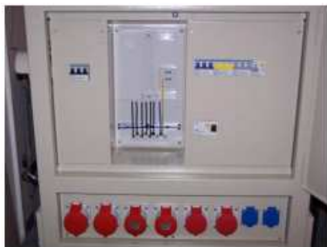
Obr. F. 6 Hlavní staveništní rozvaděč RES 2.0.2.4, zdroj: [18]
