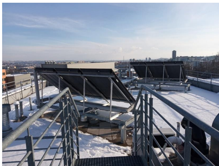
Obr. 53 Fotografie horní střechy s fotovoltaickými panely
