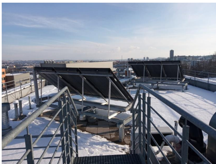
Obr. 53 Fotografie horní střechy s fotovoltaickými panely
