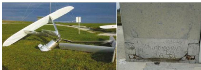
Obr. 58 Škody způsobené vibracemi [27]
