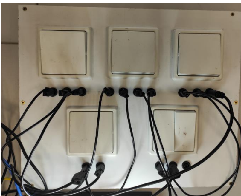
Obrázek 80: Fotografie zapojeného panelu s vypínači
