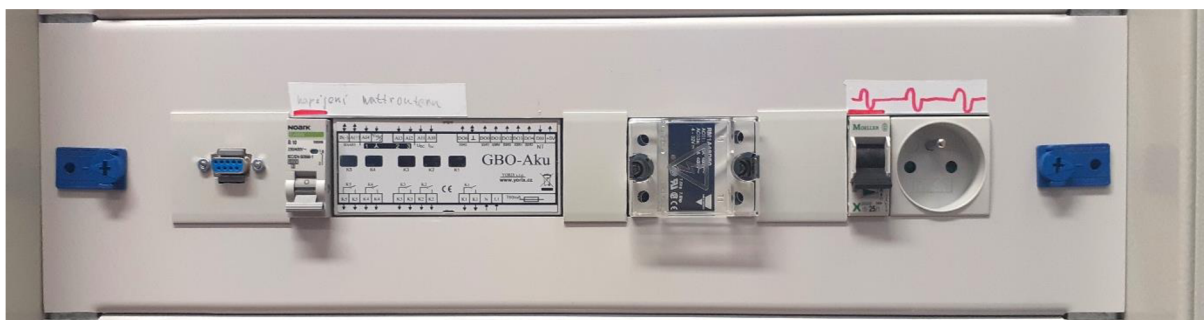
Obrázek 17: Implementace wattrouteru GreenBono AKU do silového rozvaděče [zdroj: autor]
