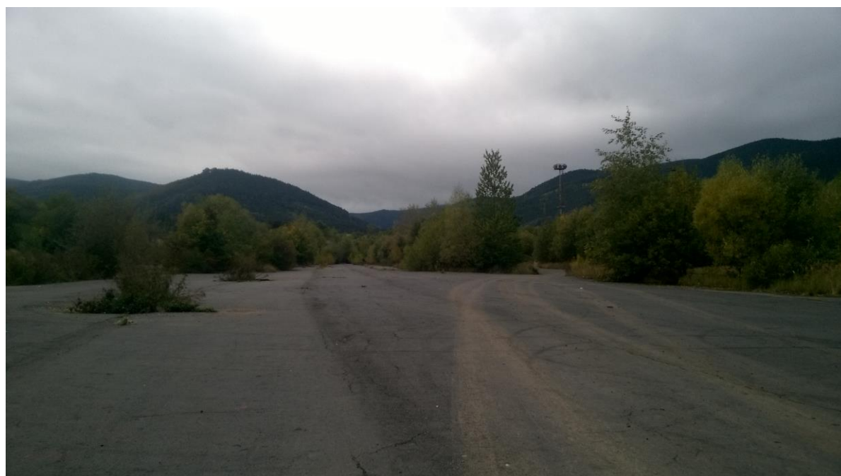
Obr. č. 27 Fotografie aktuálního stavu – asfaltová plocha s nálety
