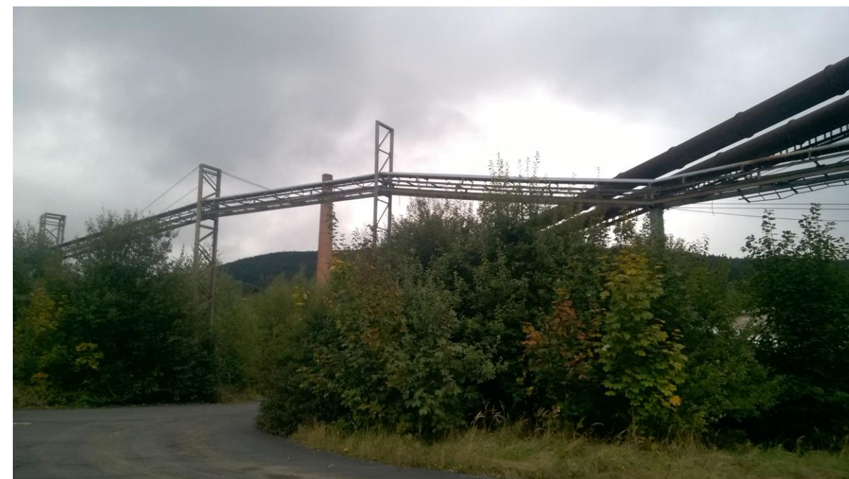
Obr. č. 28 Fotografie aktuálního stavu – konstrukce zarůstající nálety
