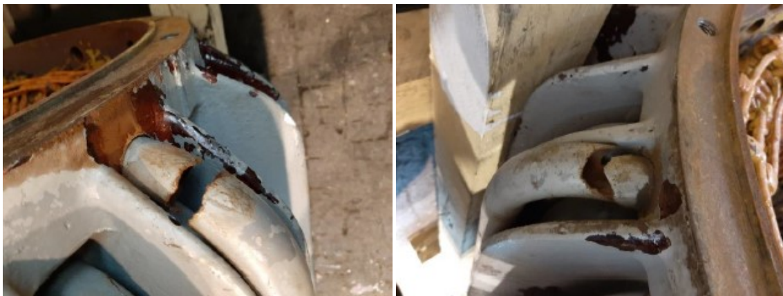
Obrázek č. 8: Koroze chladících tyčí elektromotoru
