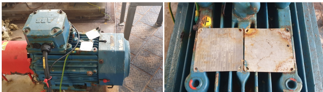
Obrázek č. 6: Koroze nýtků výkonových štítků
