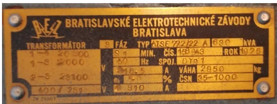
Obrázek 9-1 – fotografie štítku současně používaného transformátoru
