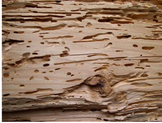
Obr. 5 Požerek tesařika krovového (Atlas poškození dřevin 2013–2014)
