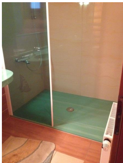
Obrázek 5 Přístup do sprchového kouta
