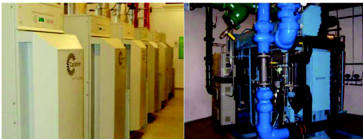
Obr. 3.7 Mikroturbíny a chladiče v datacentru university v Syracuse [8]
