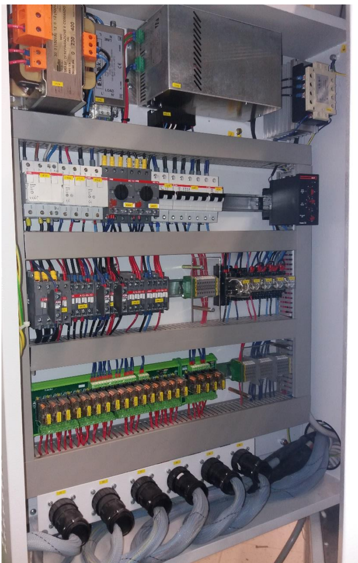
Obr. 17 Výkonová elektroinstalace komory v zadních dveřích komory
