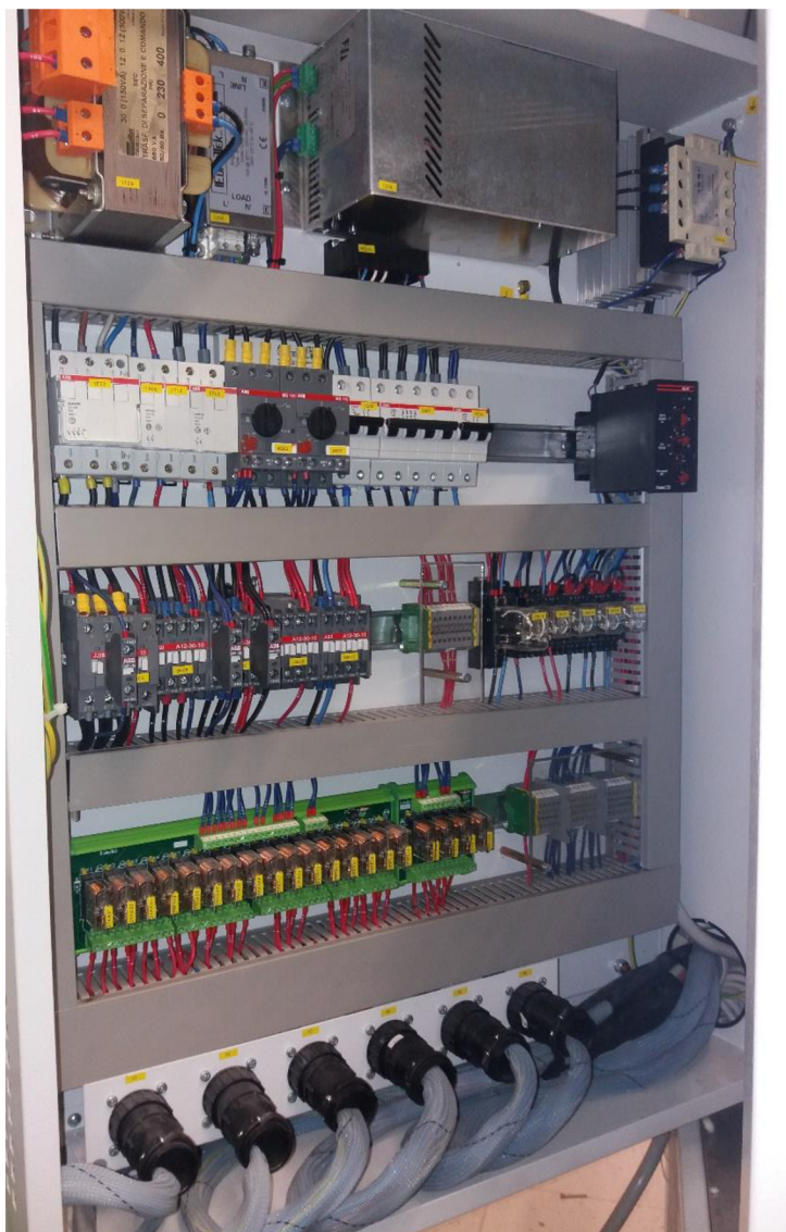
Obr. 17 Výkonová elektroinstalace komory v zadních dveřích komory
