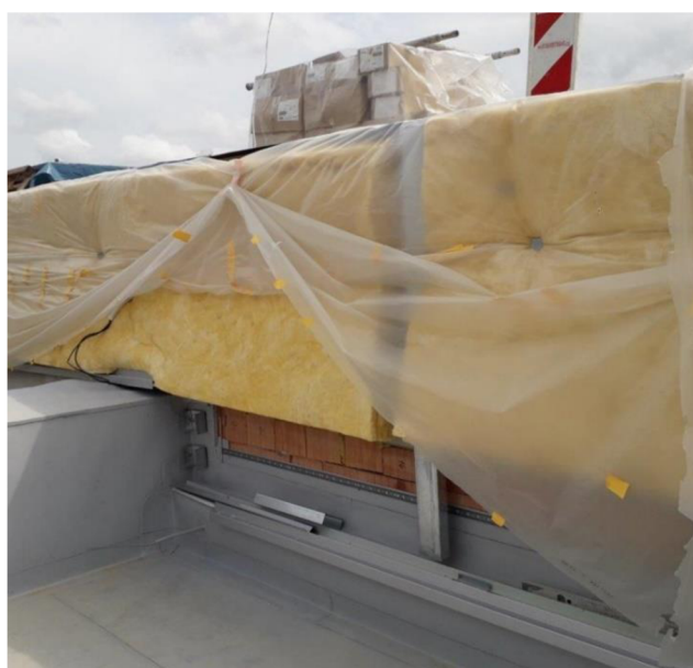
Obrázek 12 - Příklad měkké skelné vlny při použití jako tepelné izolace stěny atiky [autor]
