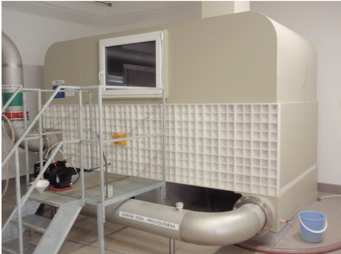
Obr. 4 – Provzdušnění ÚV České Budějovice
