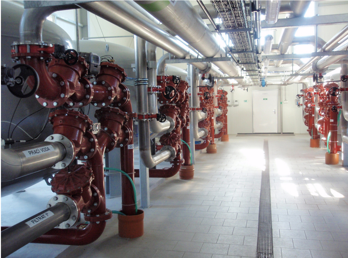
Obr. 5 – I. a II. stupeň filtrace ÚV České Budějovice
