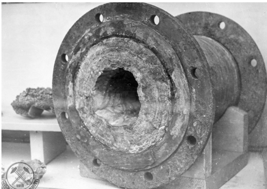
Příloha č. 10 : Zárůst armatury vřídlovcem
