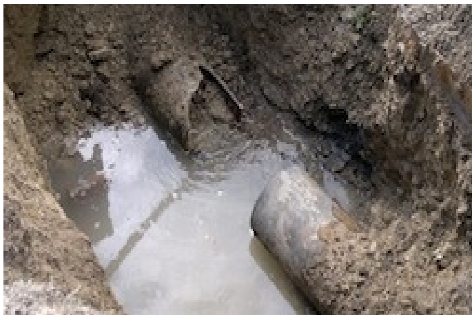
Příloha č. 3: Havárie vodovodního řadu.
