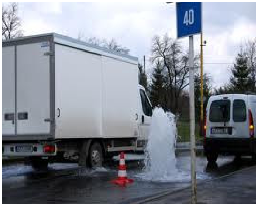
Příloha č. 2: Porucha armatury hydrantu.
