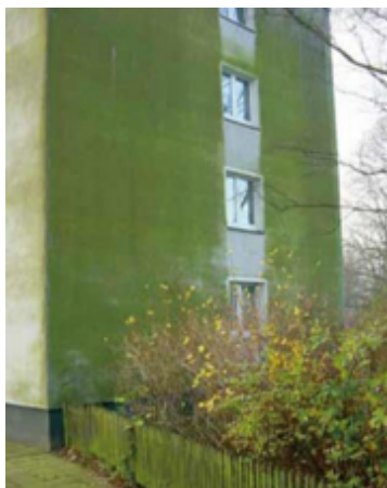
Obrázek 5 - Řasy na fasádě ETICS [17]
