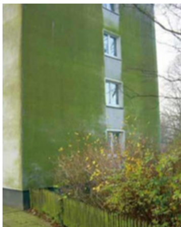
Obrázek 5 - Řasy na fasádě ETICS [17]
