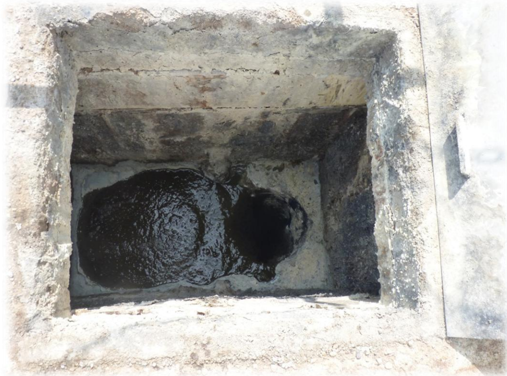
Příloha 27. Fotodokumentace vytékajícího digestátu z fermentoru (BPS Krásná Hora)
