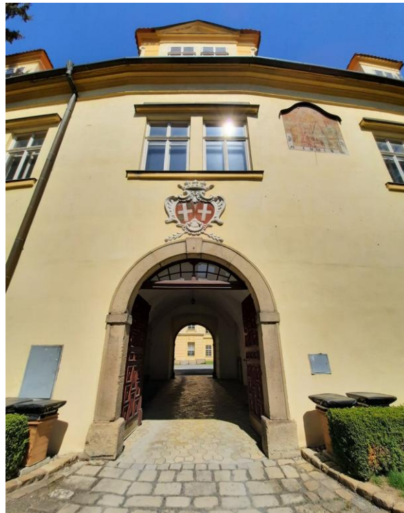
33. Průjezd na druhé nádvoří skrze jižní křídlo, současný stav, Bystřice pod Hostýnem.
