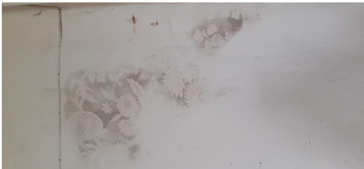
69. Motiv tapety prostupující výmalbou díky plísni, pokoj v severním křídle, druhé patro, současný stav, Bystřice pod Hostýnem.
