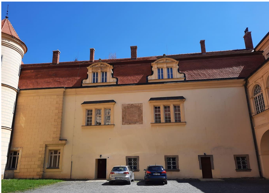
36. Východní průčelí při pohledu z druhého nádvoří, současný stav, Bystřice pod Hostýnem.
