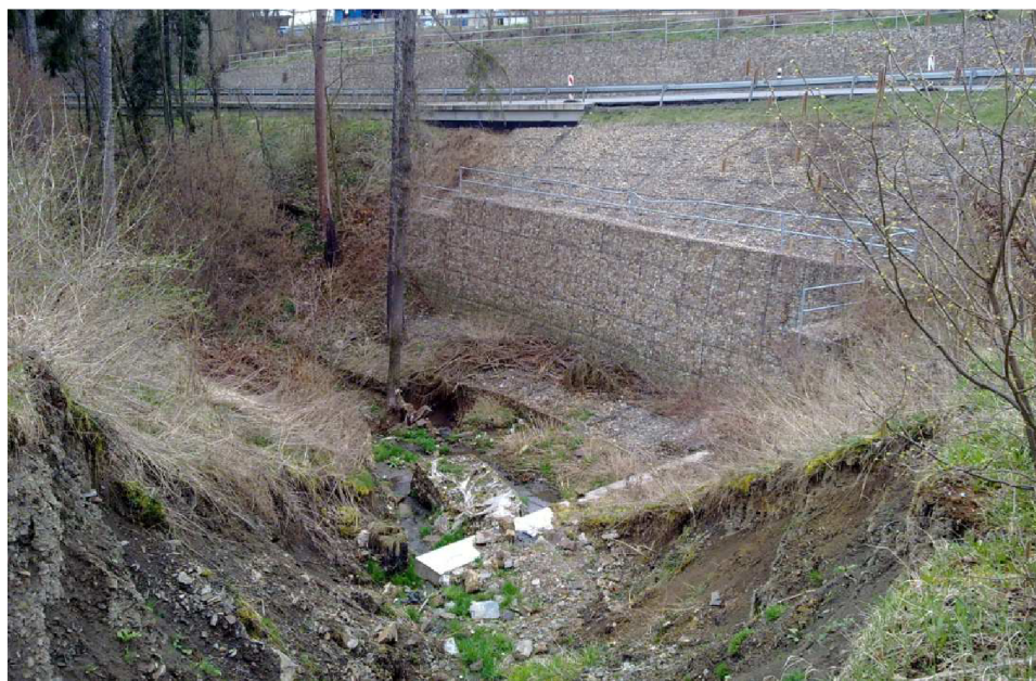
Obr.4: Pohled SZ směrem, sesuv východního svahu a gabionová zeď
