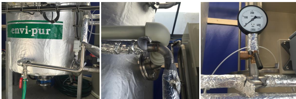
Obr. 76 Poloprovozní AnMBR - netěsnosti větve ohřevu (foto autor)
