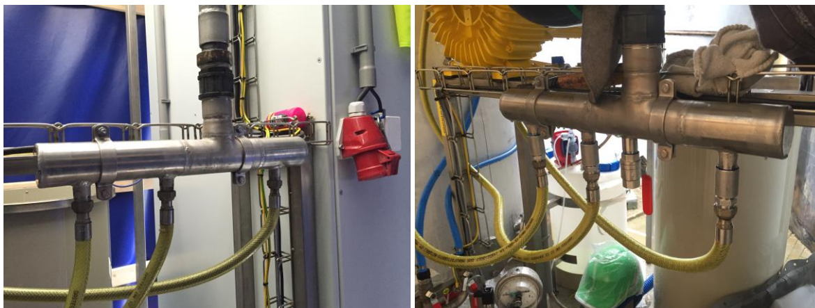
Obr. 88 Poloprovozní AnMBR - rozdělovací objekt větve bioplynu s dodatečnou výpustí kondenzátu (foto autor)
