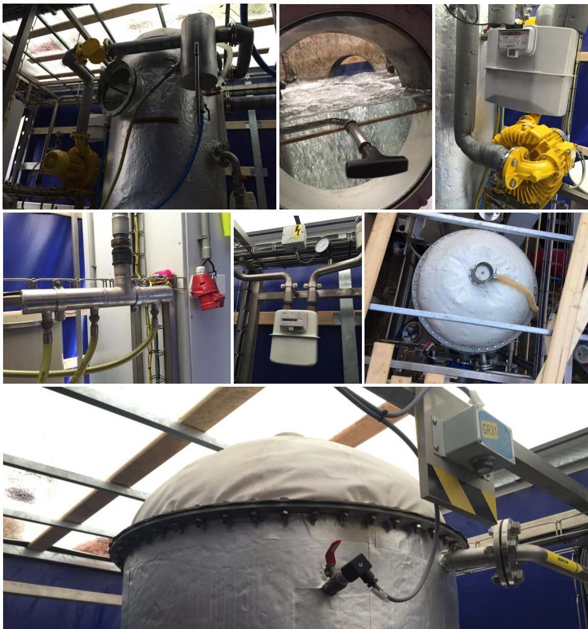
Obr. 64 Poloprovozní AnMBR - plynové hospodářství: dmychadlo, filtr, sběrná nádržka kondenzátu, aerační elementy pod membránovými moduly a rozdělovací objekt, plynoměry a plynové vaky anaerobního reaktoru / membránové komory, signalizace úniku plynu (foto autor)
