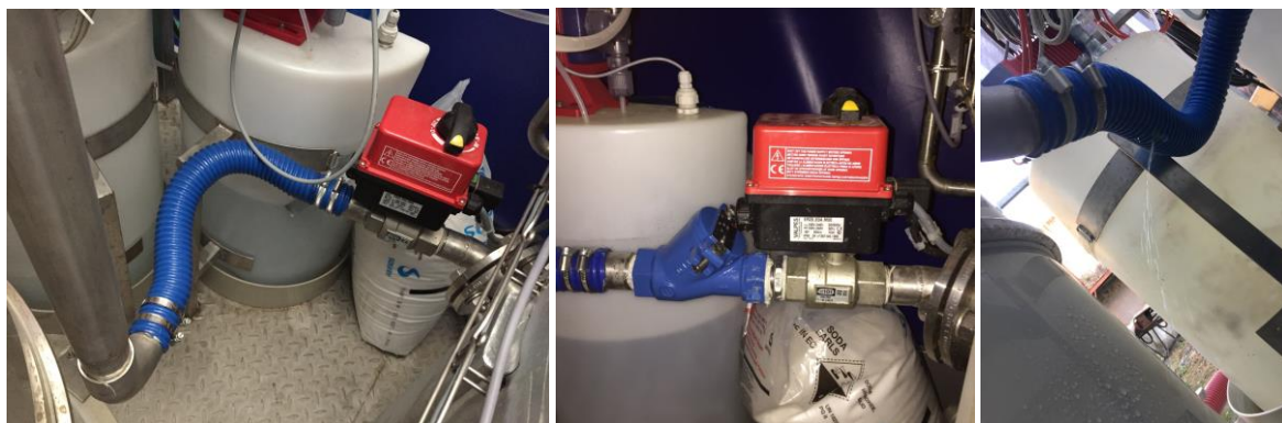
Obr. 75 Poloprovozní AnMBR - doplnění zpětné klapky mezi podávací čerpadlo a elektroventil na vstupu do anaerobního reaktoru, netěsnosti potrubí (foto autor)
