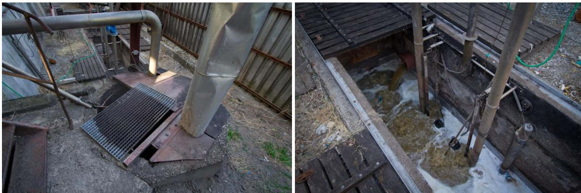
Obr. 32 ČOV Pivovar Černá Hora - čerpací stanice (foto autor, 2013)
