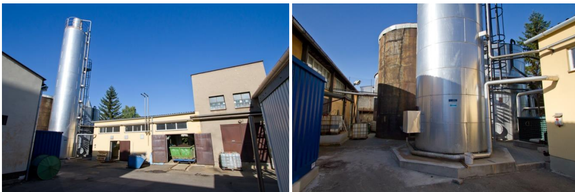
Obr. 30 Anaerobně-aerobní ČOV Pivovar Černá Hora (foto autor, 2013)
