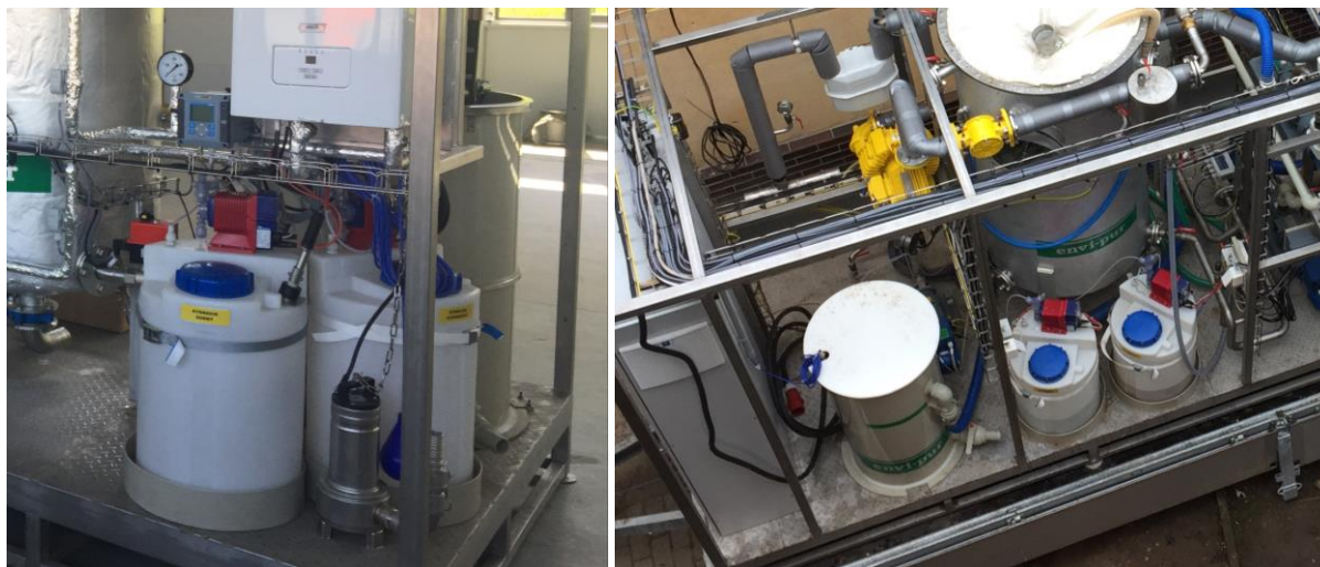
Obr. 63 Poloprovozní AnMBR - chemické hospodářství pro přípravnou nádrž a membránovou komoru (foto autor)
