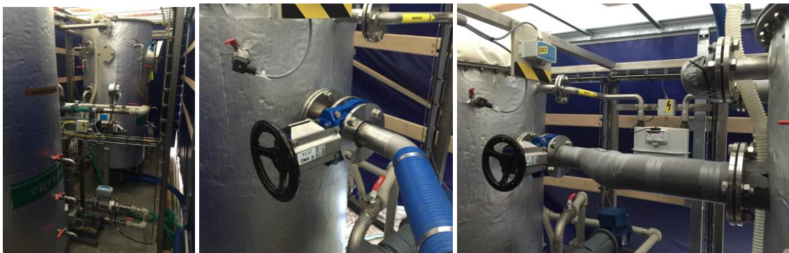
Obr. 82 Poloprovozní AnMBR - úpravy propojovacího potrubí mezi membránovou komorou a anaerobním reaktorem - uzávěr a tepelná izolace (foto autor)
