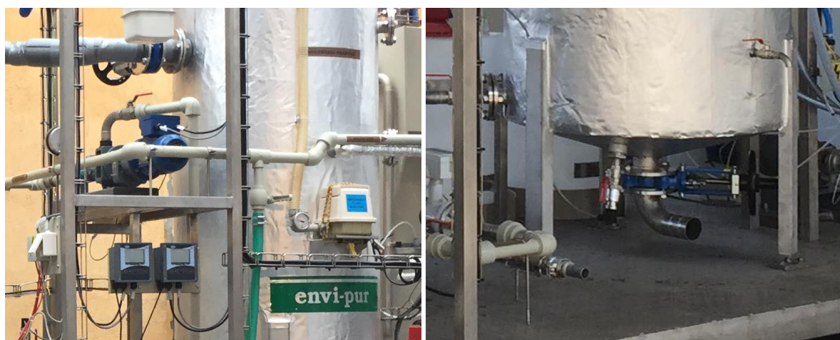
Obr. 58 Poloprovozní AnMBR - vřetenové míchací čerpadlo, spodní výpusti (foto autor)
