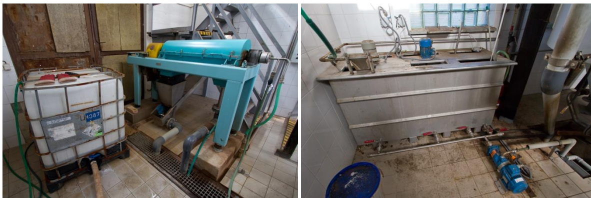
Obr. 40 ČOV Pivovar Černá Hora - kalová odstředivka a flokulační stanice (foto autor, 2013)
