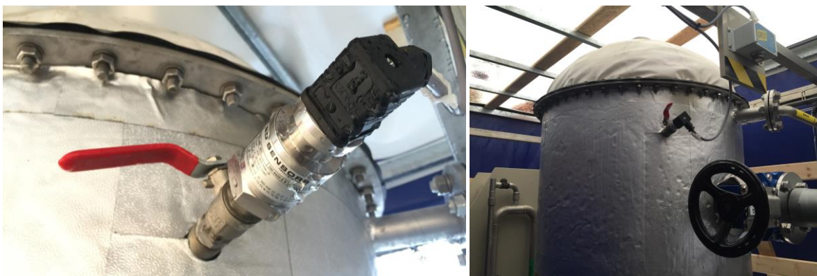
Obr. 77 Poloprovozní AnMBR - výměna tlakových senzorů (foto autor)
