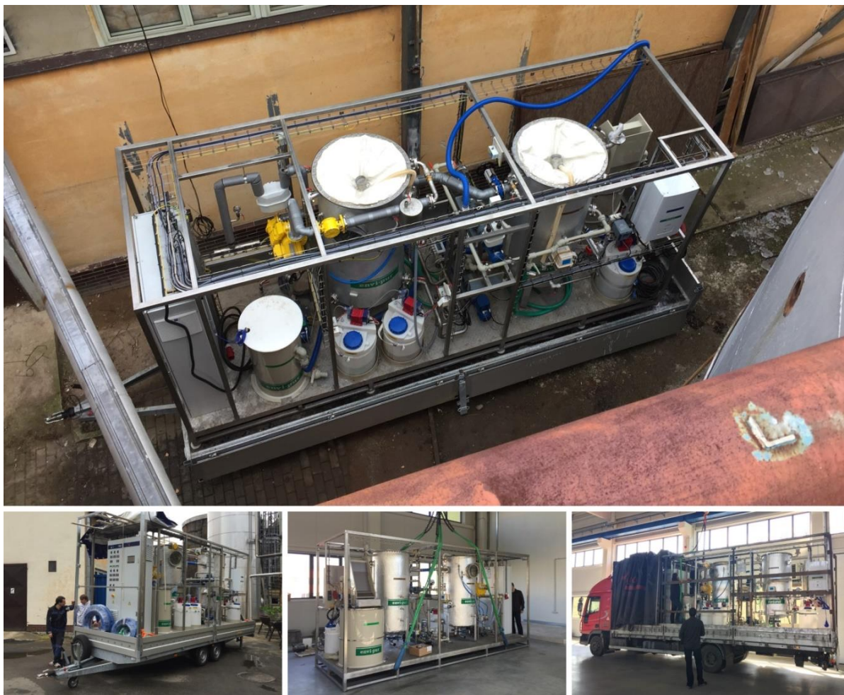
Obr. 70 Poloprovozní AnMBR jednotka (foto autor)
