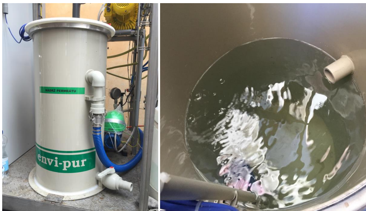
Obr. 61 Poloprovozní AnMBR - nádrž permeátu (foto autor)
