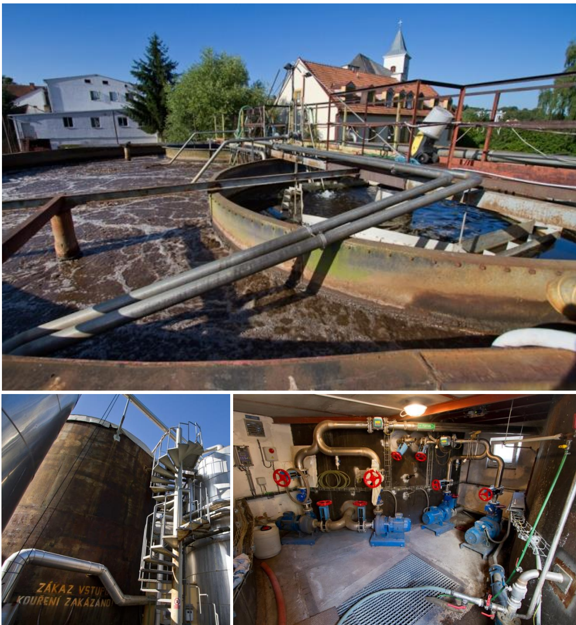
Obr. 38 ČOV Pivovar Černá Hora - aktivační nádrž s vestavnými dosazovacími nádržemi, uskladňovací nádrž kalu, armaturní komora (foto autor, 2013)
