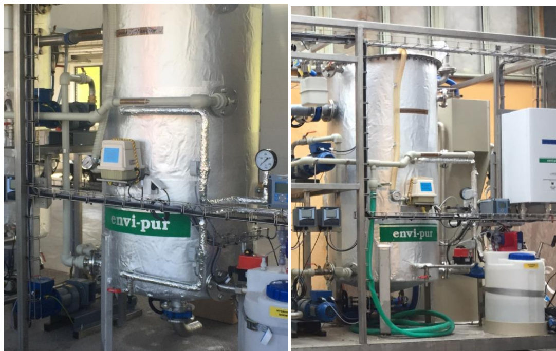
Obr. 81 Poloprovodní AnMBR - ddbočka potrubí míchání anaerobního reaktoru pro provoz v SBR režimu (foto autor)
