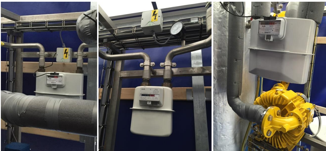
Obr. 93 Poloprovozní AnMBR - výměna plynoměrů (foto autor)
