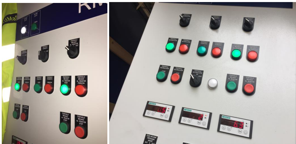
Obr. 96 Poloprovozní AnMBR - umožnění zpětného chodu recirkulačního čerpadla - ovládání a signalizace (foto autor)
