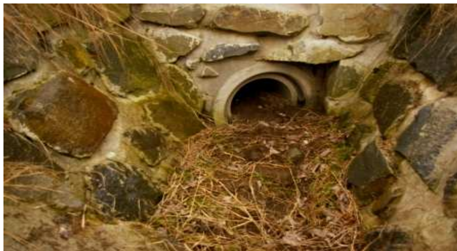
Foto 19: Zpola zanesený propustek [1]
