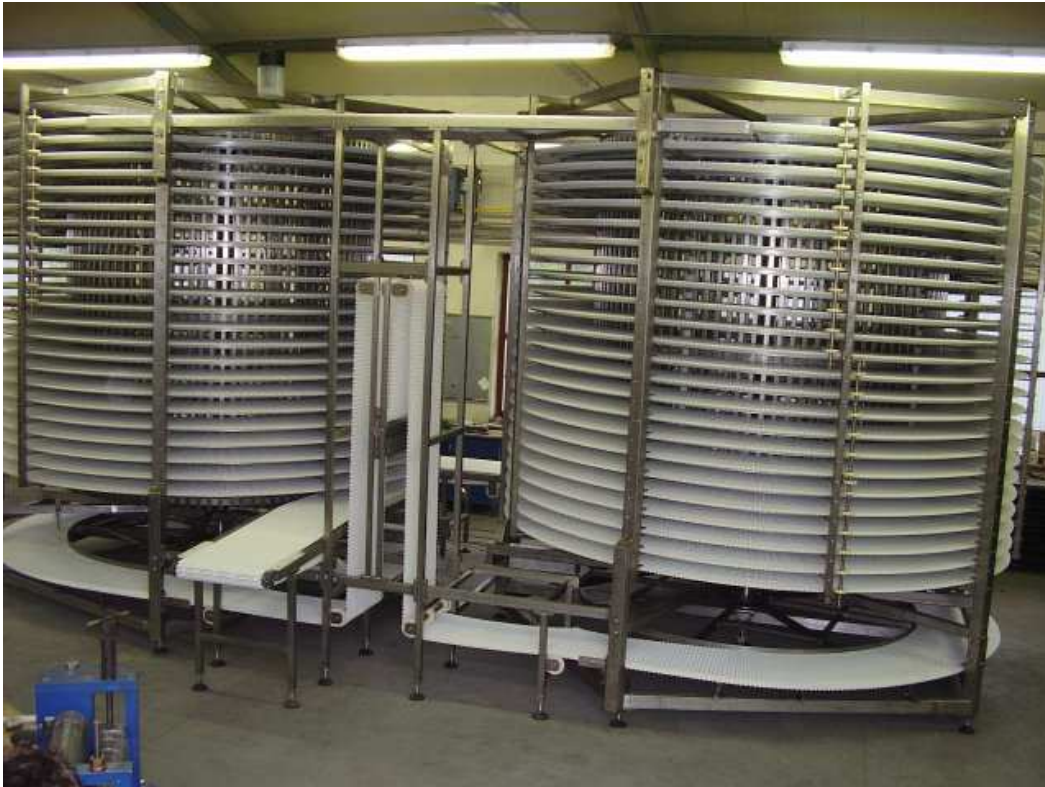
Obr. 12: Spirálové chladicí věže Zdroj: [30]
