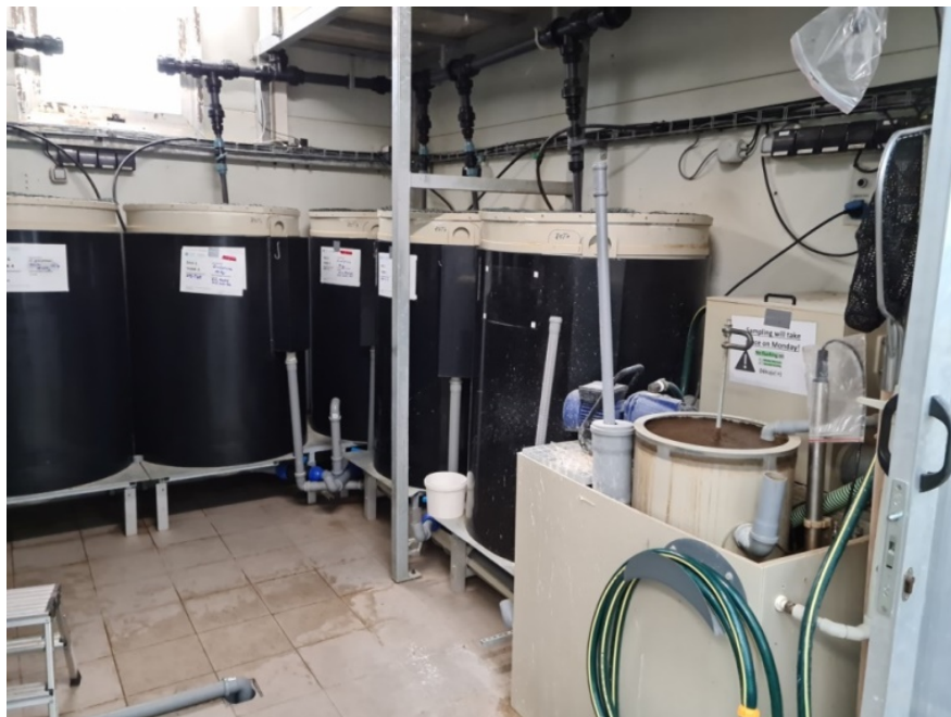
Obr. 25: Recirkulační akvakulturní systém (foto autor)
