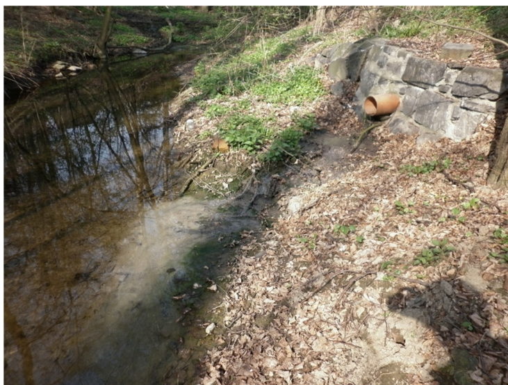
Odpadní výust' PVC DN200 ř. km 2,616
