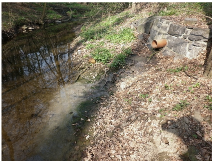
Odpadní výust' PVC DN200 ř. km 2,616
