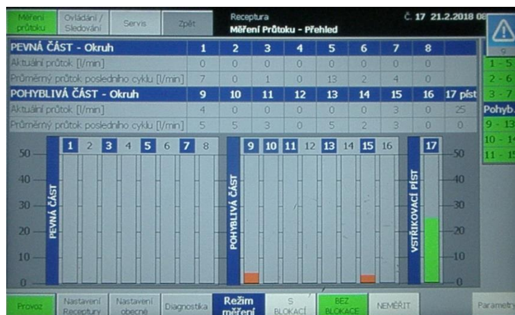
Obr. 3-4 Řídicí panel zařízení na regulaci průtoku chladicí vody
