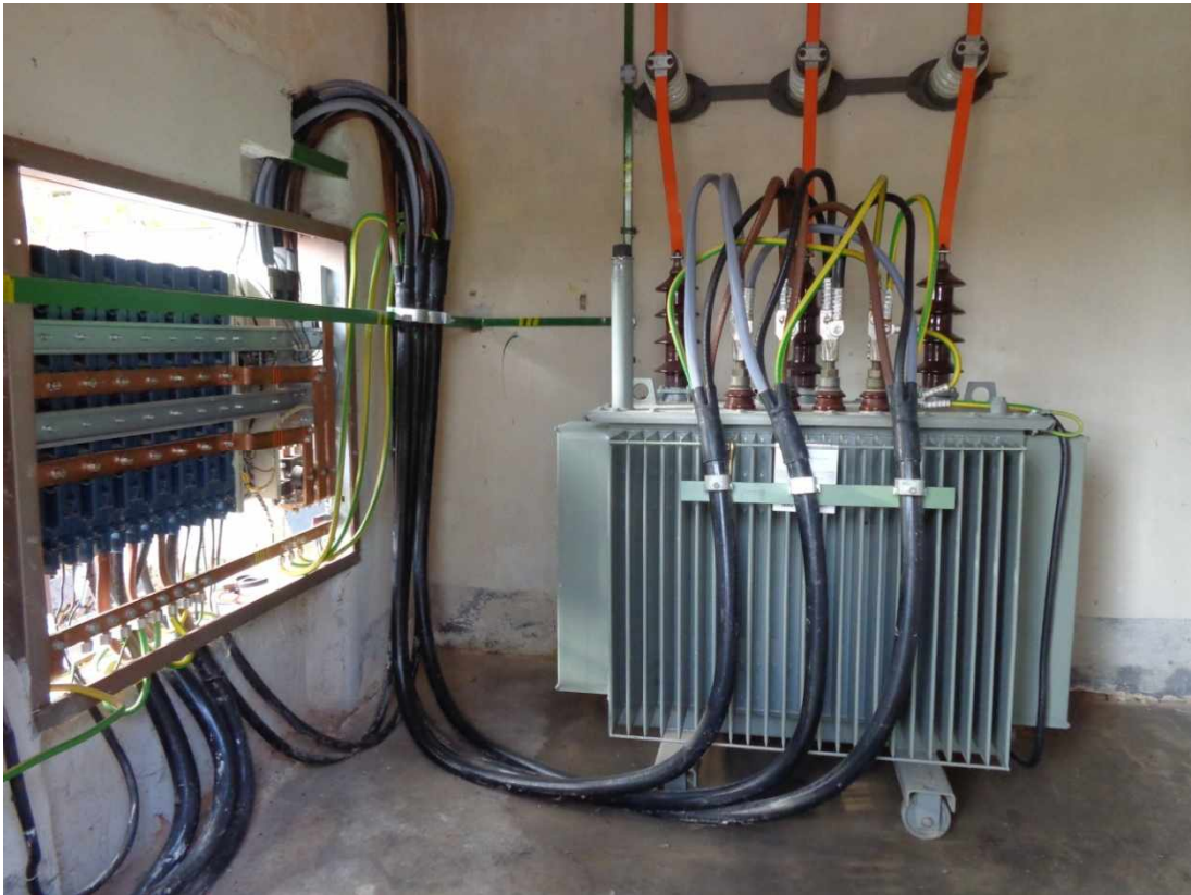
Obrázek 3-9: Vnitřní prostory trafostanice
