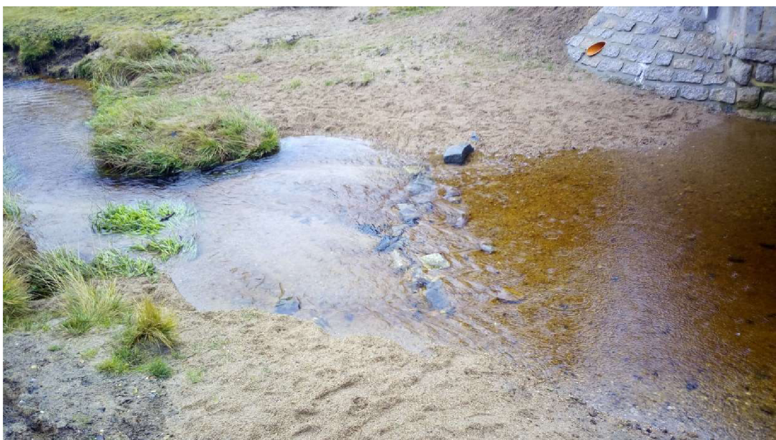
Obrázek 4: Lokalita 2: zúžení toku pod mostem vlivem sesunu břehu, vytváří se příčná hrubozrná hráz, za ní vznikají čeríny. Foto ze dne 19. listopadu 2020
