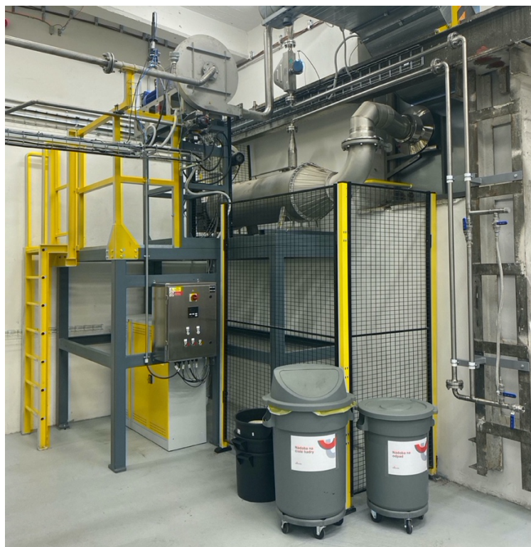
Obrázek 27 - Pohled na ventilátor a spalovací komoru
