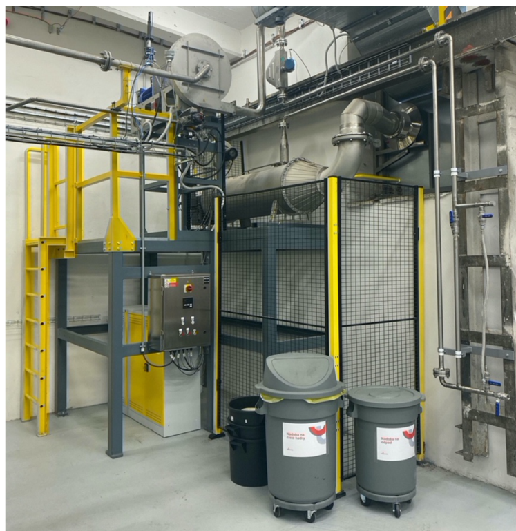
Obrázek 27 - Pohled na ventilátor a spalovací komoru
