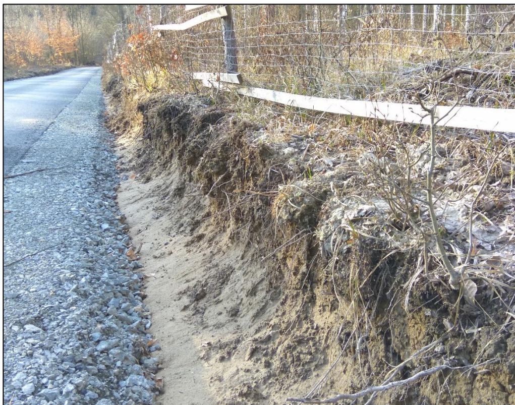
Obr. 37: Silniční odkop, lesní cesta Nové Mlýny (foto: L. Leibnerová, březen 2018).
