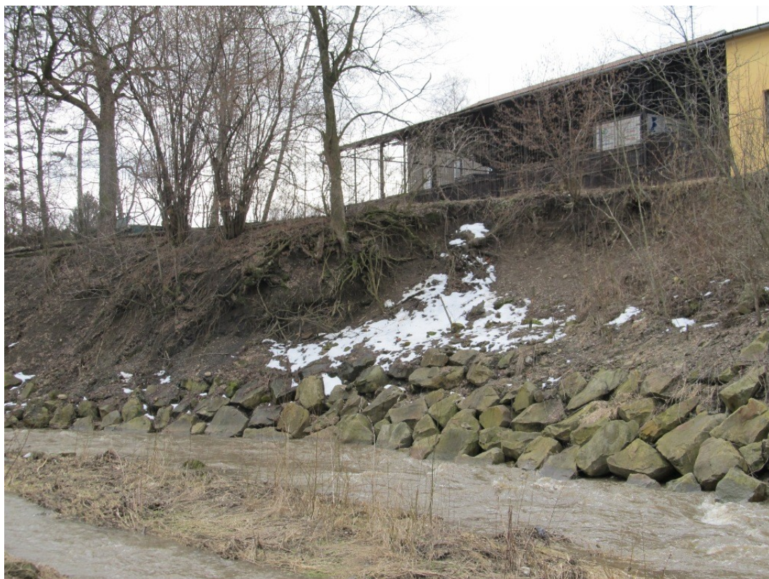
Obr. 17: Stabilizovaný sesuv u SZŠ v Žilině u Nového Jičína. (Zdroj: vlastní foto)
