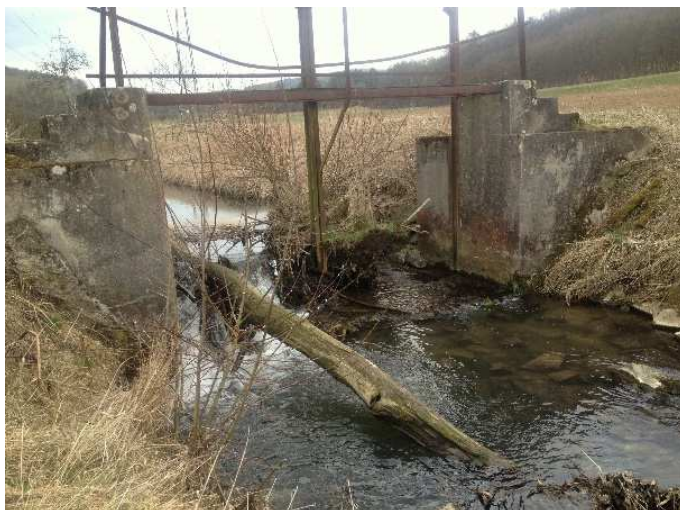
Obr. 2.4 Dřevěné dvoupólové stavidlo (autor: Lucie Holá)
