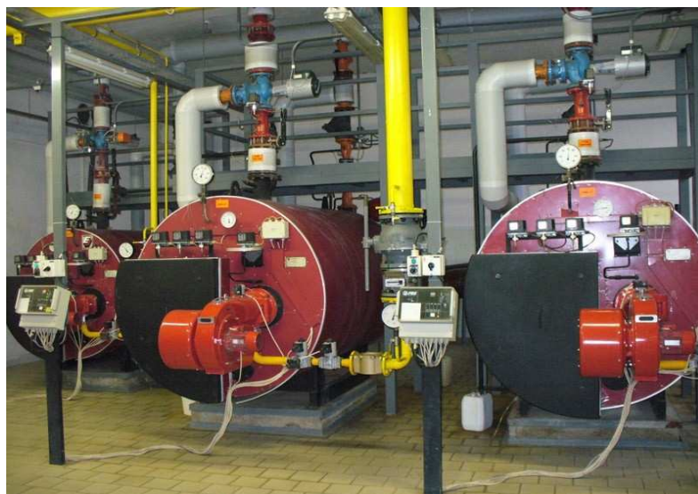
Obr. 4 Plynové kotle kotelny ul. Křížkovského (20).
