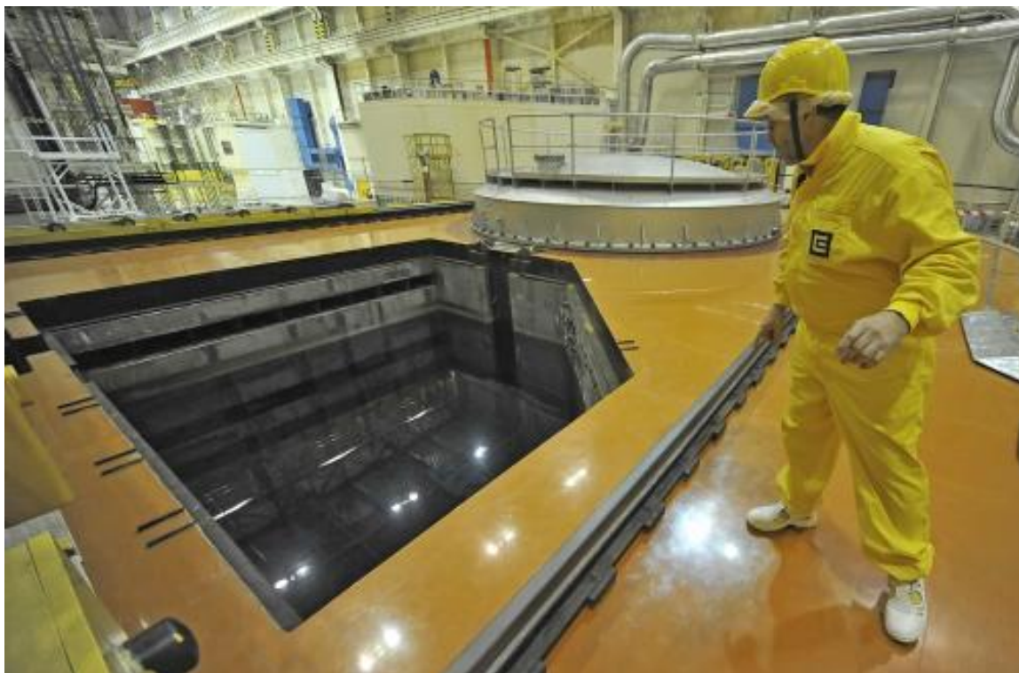
Obr. 5: Bazén vyhořelého paliva v elektrárně (66)
