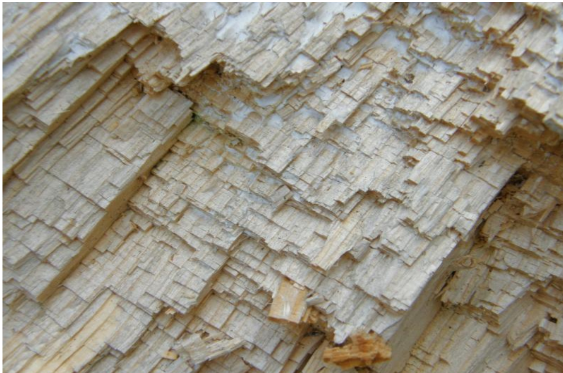
Obrázek č. 19: Detail rozkladu způsobené plstnatečkem severským - Křtiny 2009.
