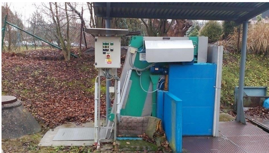
Obr. 6.1 Strojně stírané česle na ČOV Ostrov u Macochy
