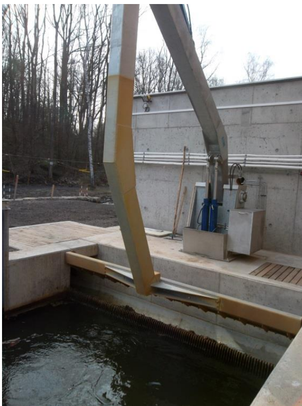
Obr.22 MVE Stružnice, jemné česle, mechanismus na odstraňování splávi (vlastní)
