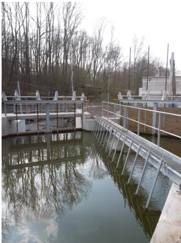
Obr.21 MVE Stružnice, hrubé česle, jezová propust, vtok (vlastní)
