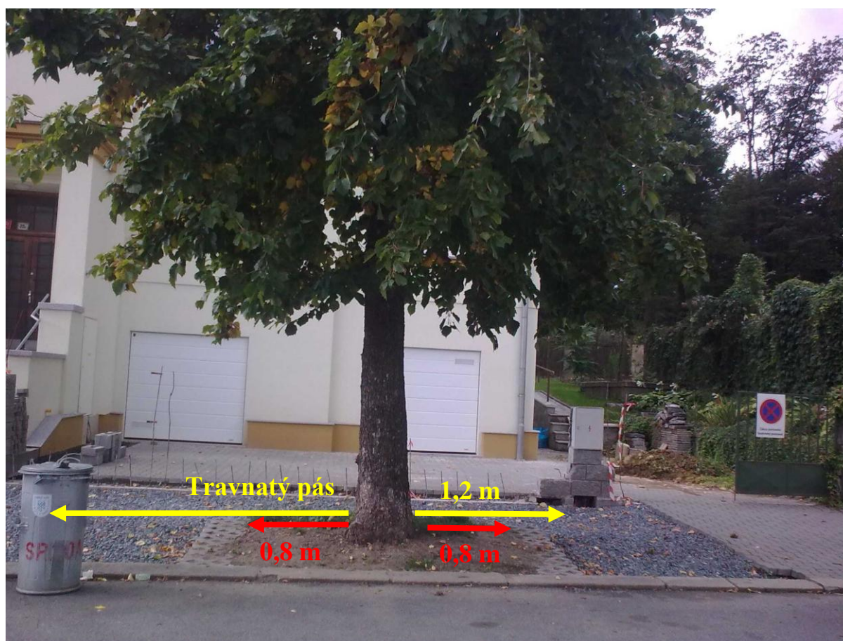
Obr. 14: Poškozená líska turecká během stavby nového vjezdu. Červeně vyznačená je reálná situace, žlutě pak podmínky orgánu ochrany přírody stanovené při povolování stavby. Autor Štěpánková J., 17. 9. 2010.
