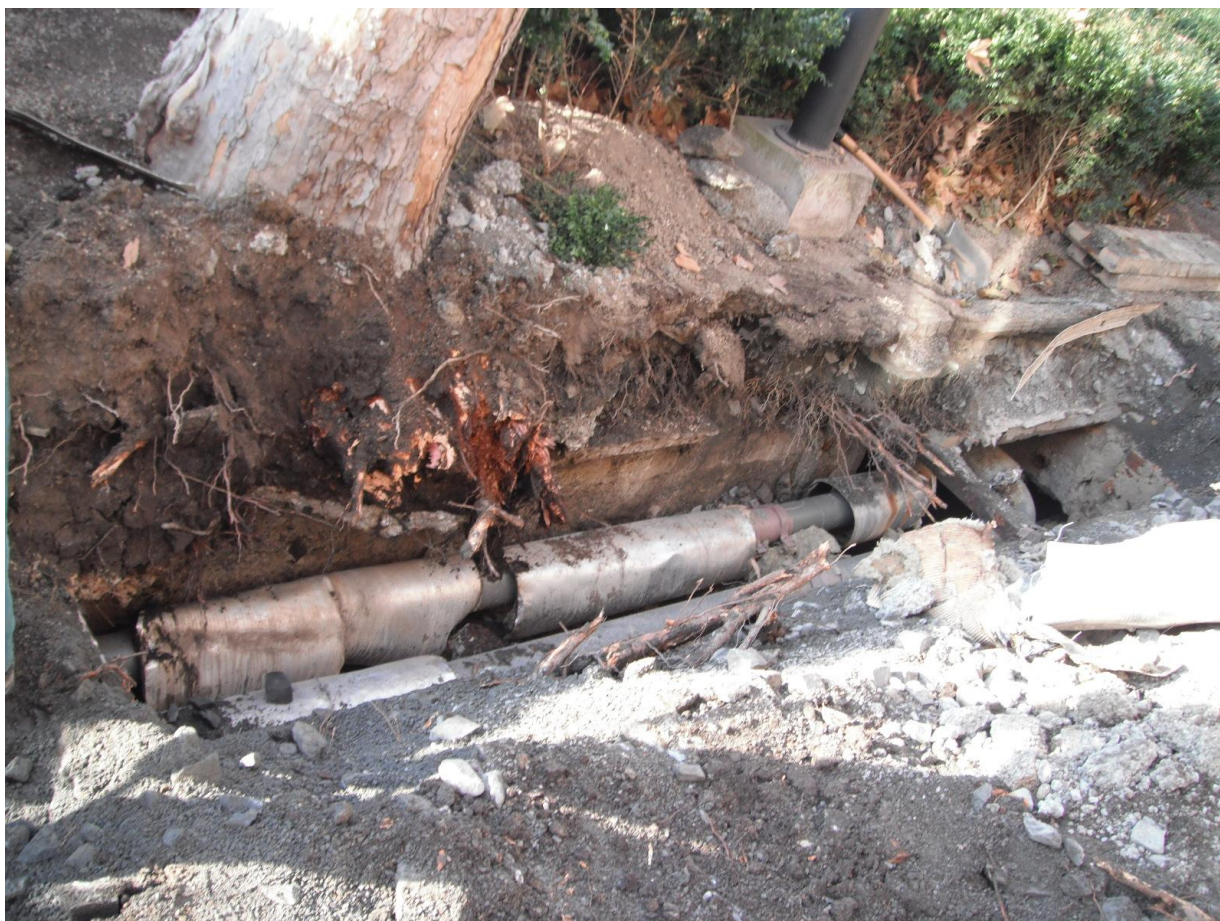
Obr. 12: Výkop v kořenovém prostoru platanu v důsledku havárie horkovodu. Autor Štěpánková J., 19. 12. 2011.
