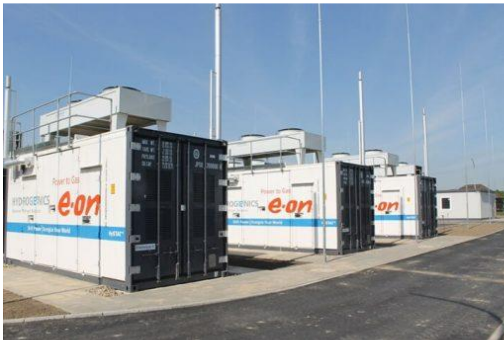
Obr. 11 Bateriové úložiště společnosti E.ON. [24].
