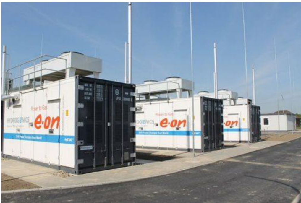
Obr. 11 Bateriové úložiště společnosti E.ON. [24].
