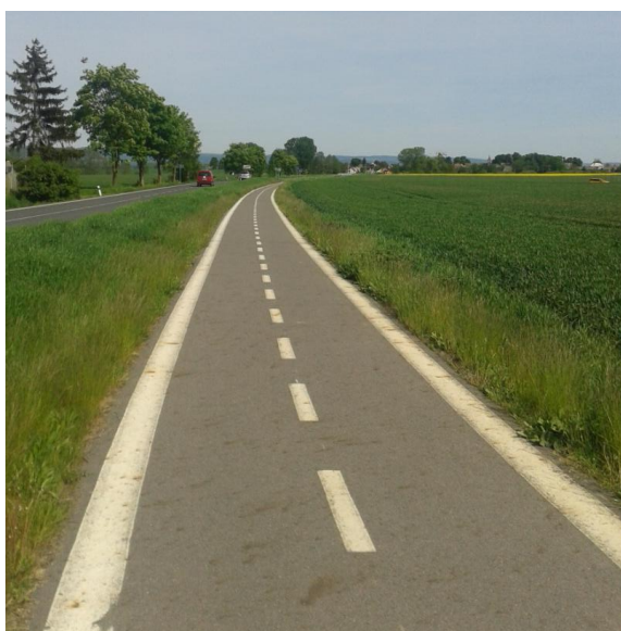
Obr. 11: Cyklostezka Želechovice - Uničov
