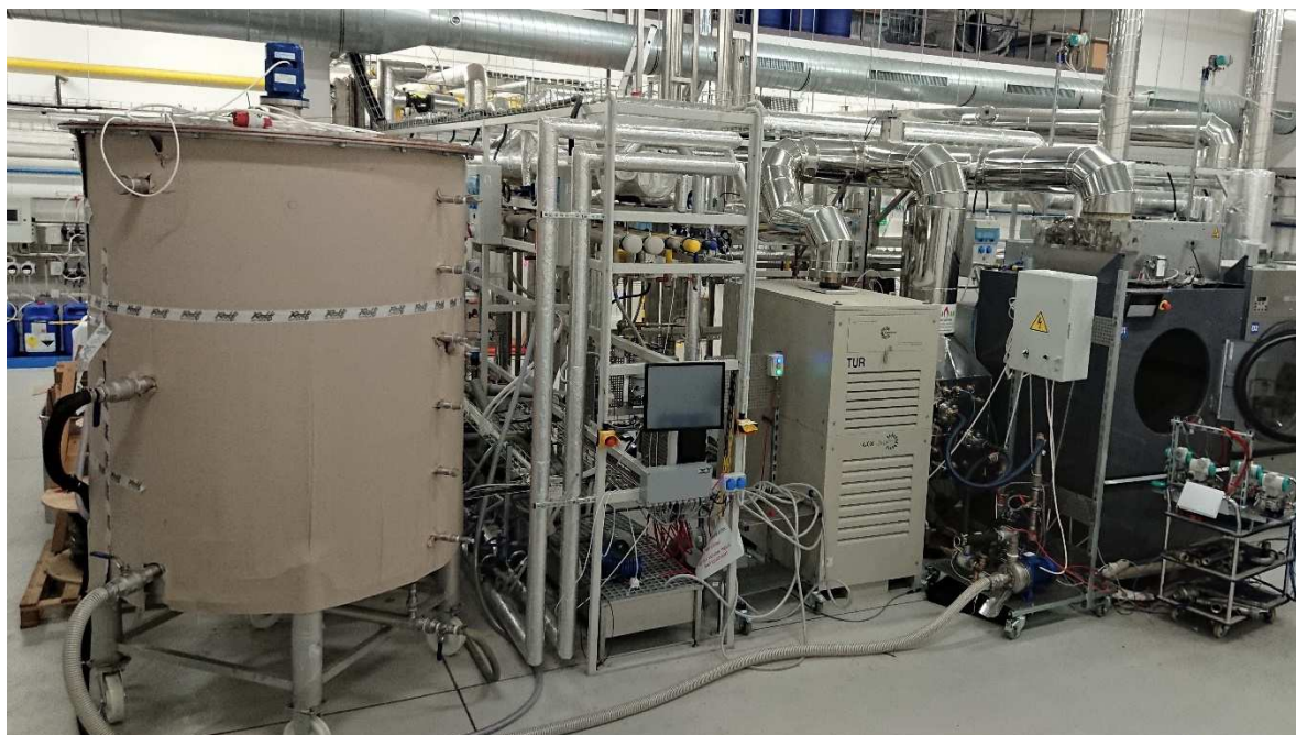
Obr. 8 Realizovaná podoba kogeneračního systému v LENP
