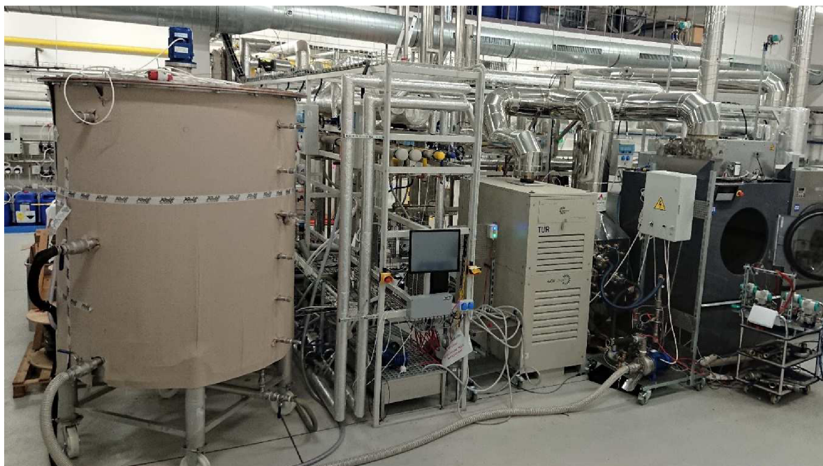
Obr. 8 Realizovaná podoba kogeneračního systému v LENP
